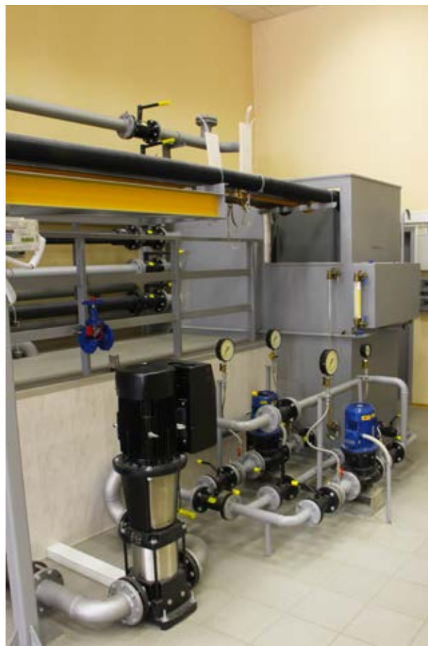
Лабораторная насосная установка GRUNDFOS
