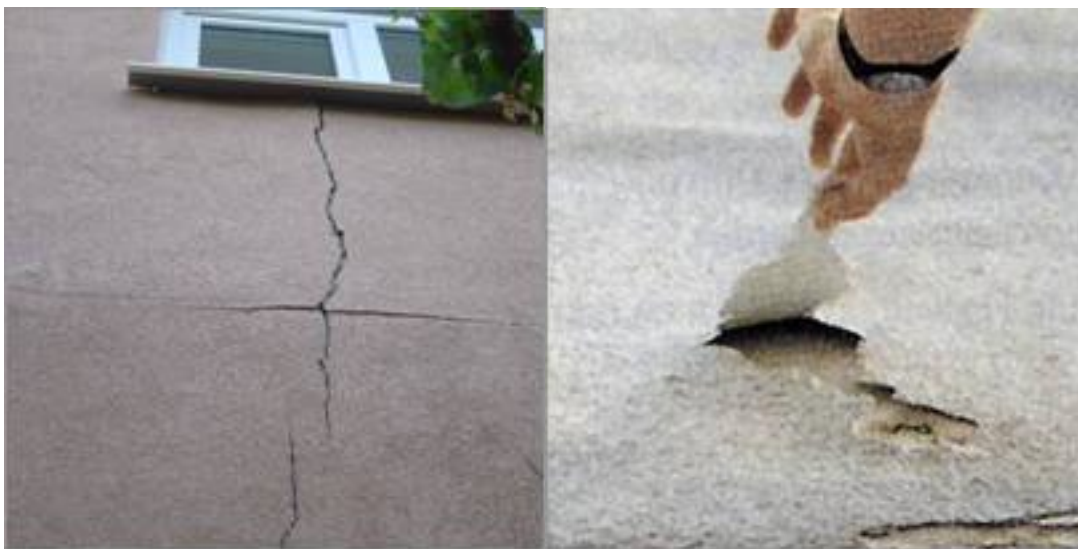
Рисунок 10 - Разрушение штукатурного слоя
