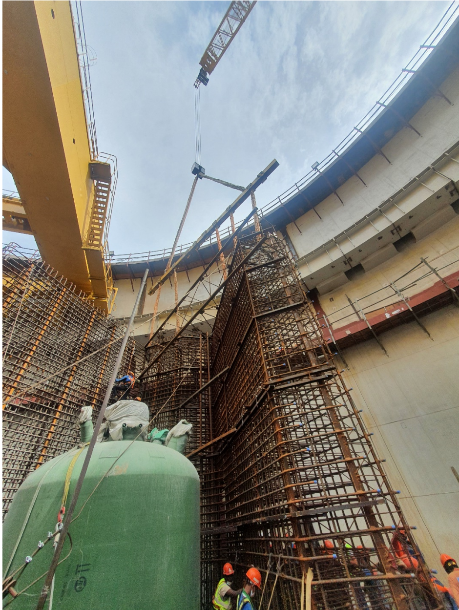
Рисунок 1.4. Монтаж армоблока стены помещения компенсатора давления без несъемной опалубки на АЭС «Руппур» (Народная Республика Бангладеш).
